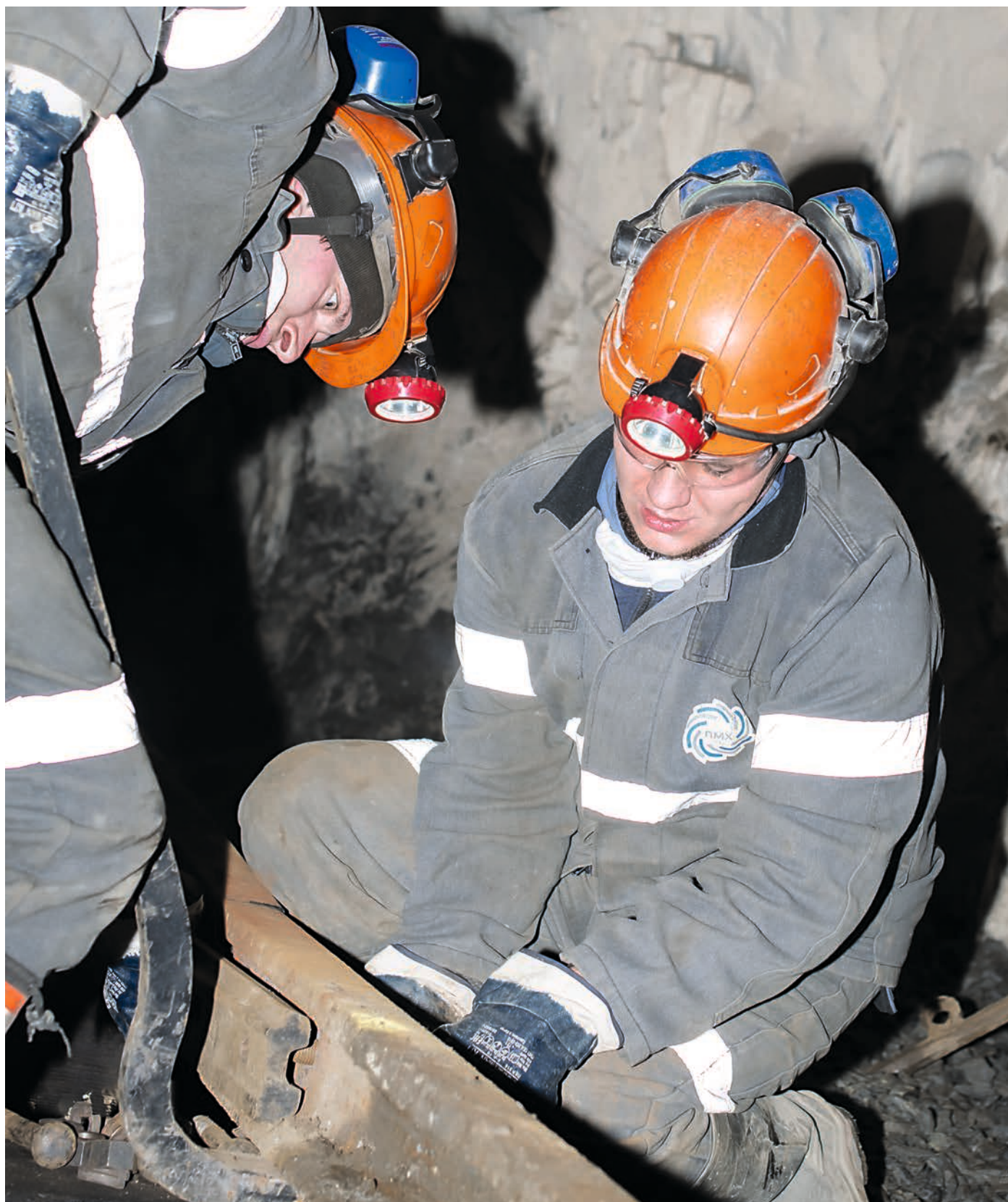
Дорожно-путевой рабочий Александр Домнин (справа) выполняет конкурсное задание по монтажу рельсового пути с помощью Дениса Балина.
