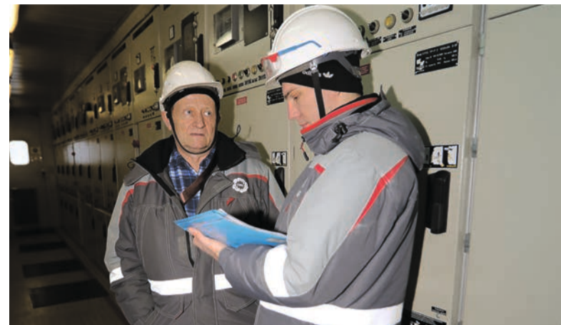
Начальник участка сетей и подстанций Валерий Щербаков (слева) рассказывает специалисту отдела внутреннего контроля Артему Загарских об обеспечении сохранности имущества на трансформаторной подстанции.
