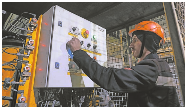
Щит управления гидравлической станции для регулирования разгрузочной щели дробилки TP-600.
